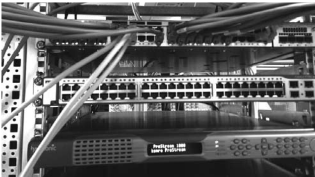
Ein Blick auf die neue Kabelkopfstation.
